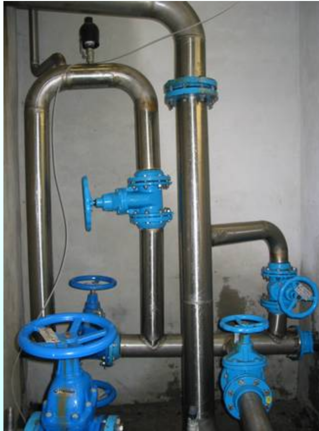
SCHIEBERKAMMER MIT ARMATUREN
