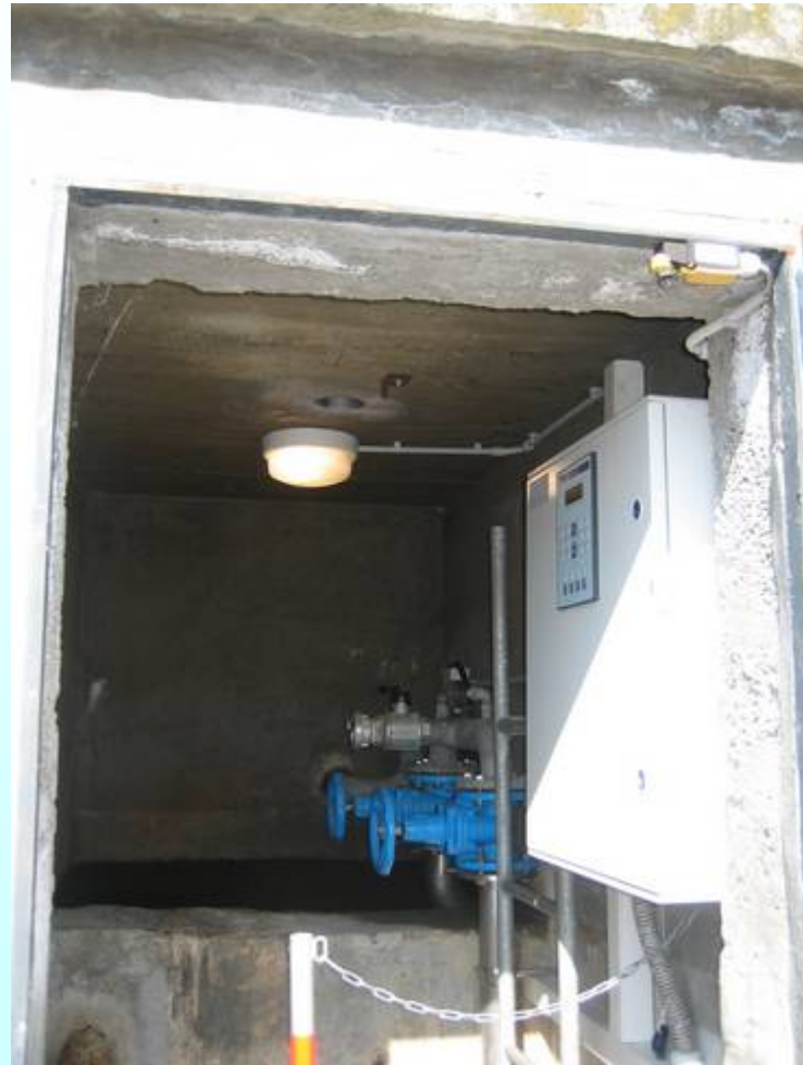
SCHIEBERKAMMER MIT ARMATUREN
