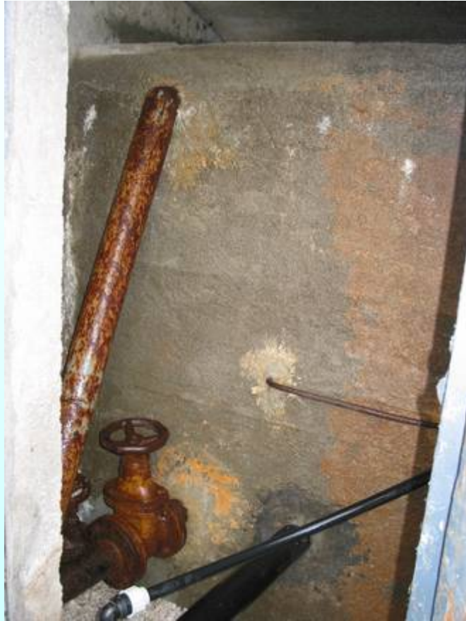
SCHIEBERKAMMER MIT ARMATUREN
