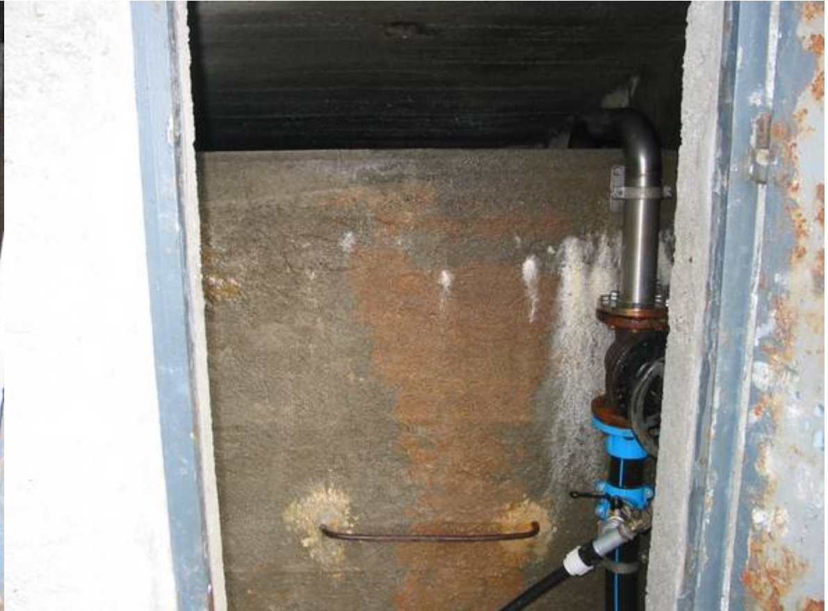
SCHIEBERKAMMER MIT ARMATUREN
