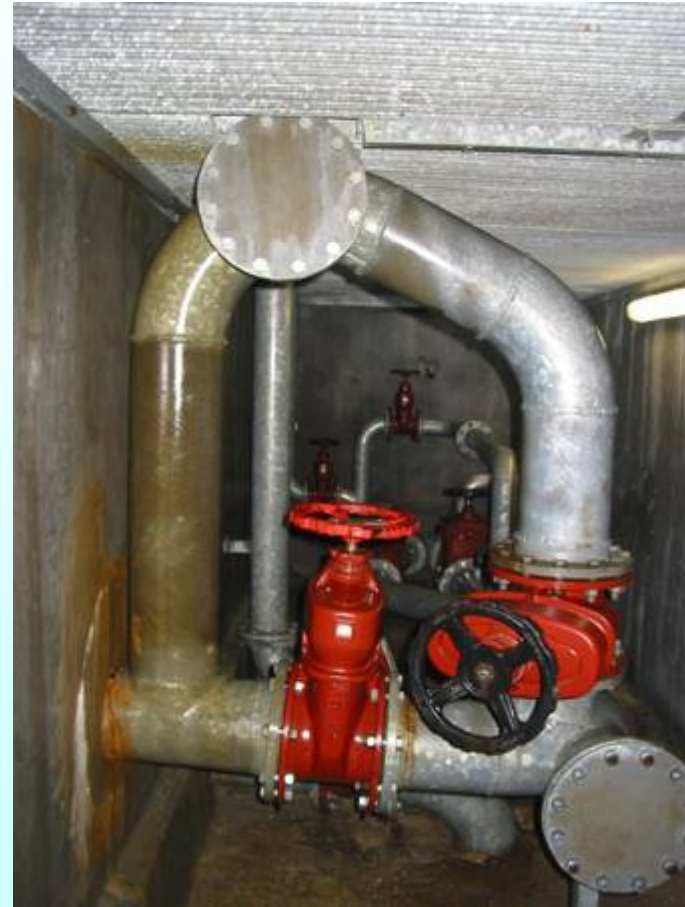
SCHIEBERKAMMER MIT ARMATUREN
