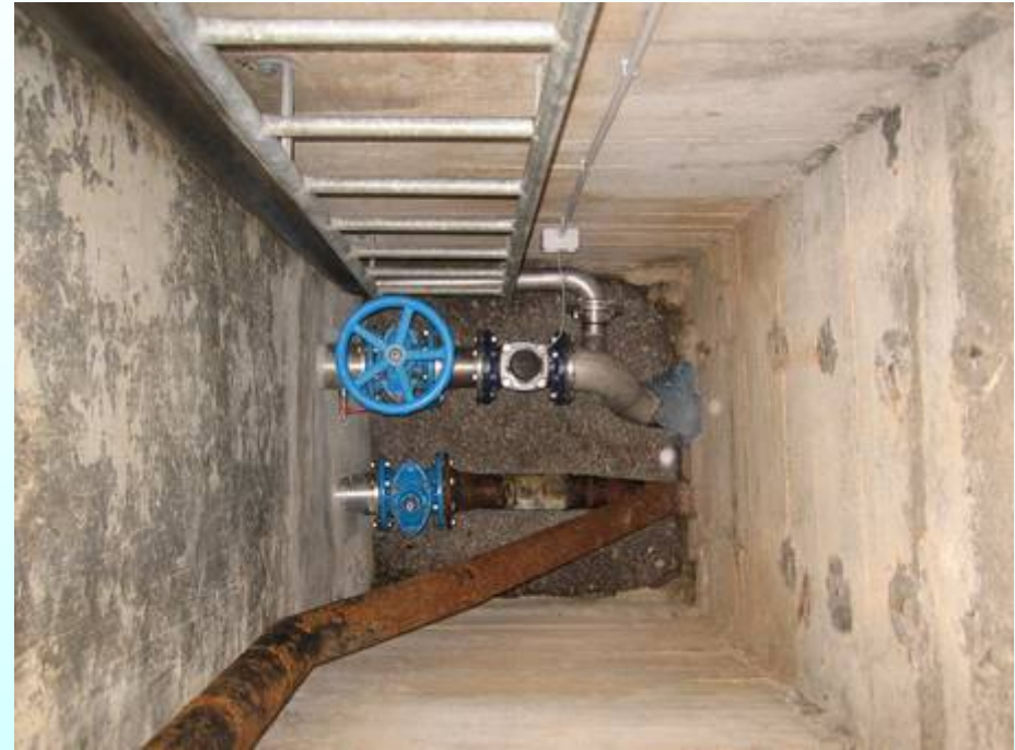
SCHIEBERKAMMER MIT ARMATUREN
